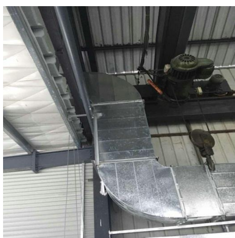
图 7 喷烤漆房废气排放装置
