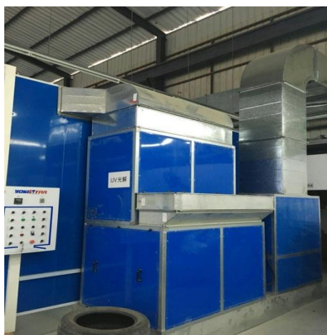
图 5 喷烤漆房废气处理装置
