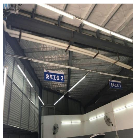
图 8 焊接废气收集排放装置
