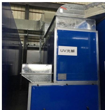
图 6 喷烤漆房废气处理装置
