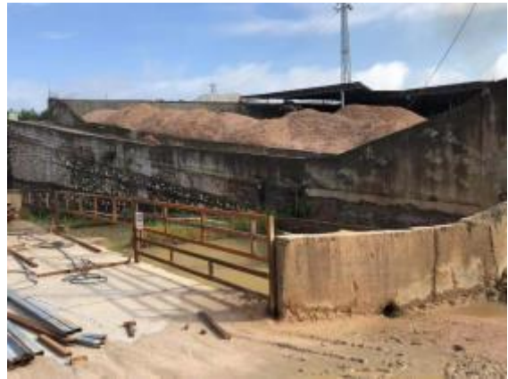
二号场沉淀池
