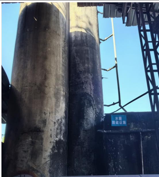
水膜/脱硫除尘设施
