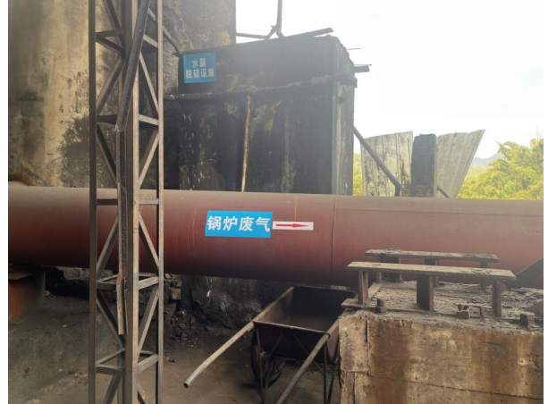
废气管道标识
